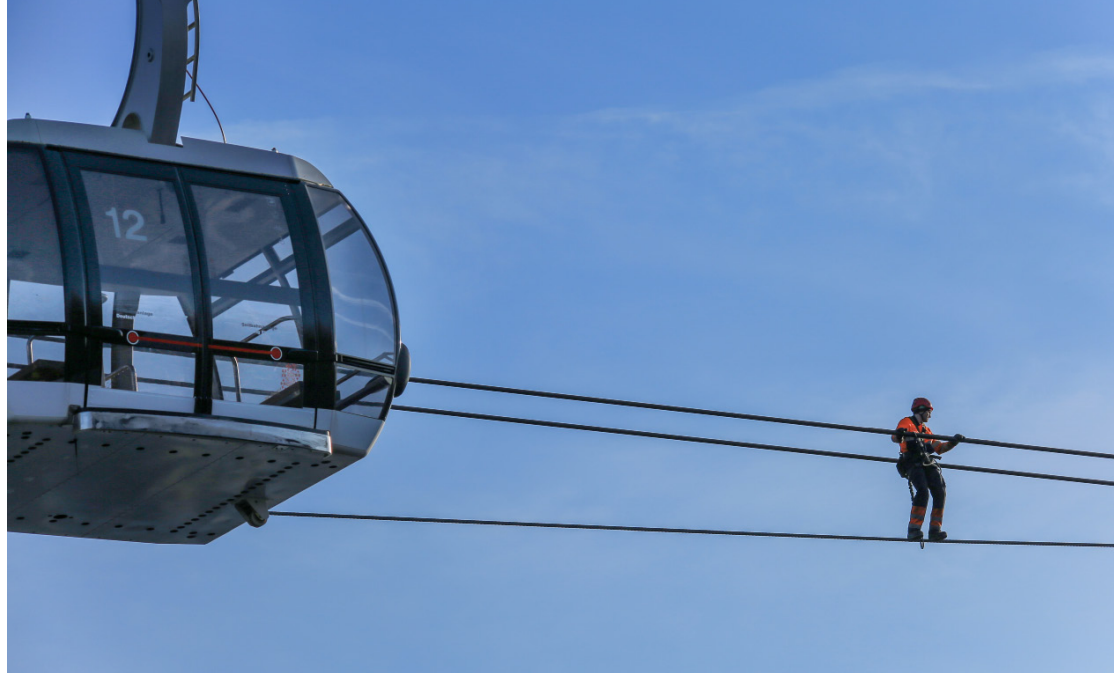
Die Seile der Seilbahn werden jährlich kontrolliert und gewartet. Das dient der Sicherheit und einem längeren Betrieb.
